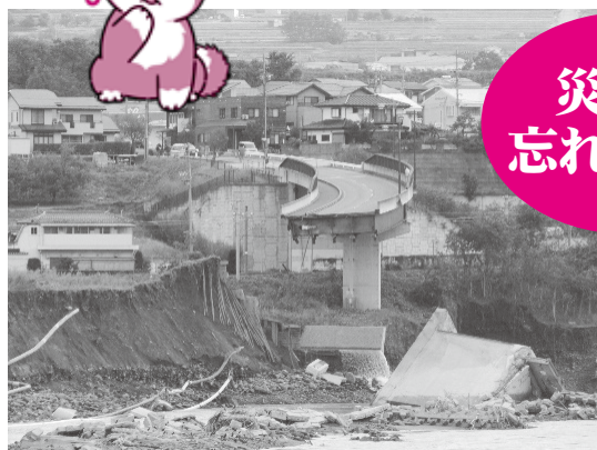
▲令和元年台風19号で被害を受けた海野宿橋
